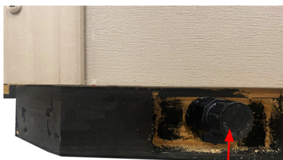
Tapa de desagüe
